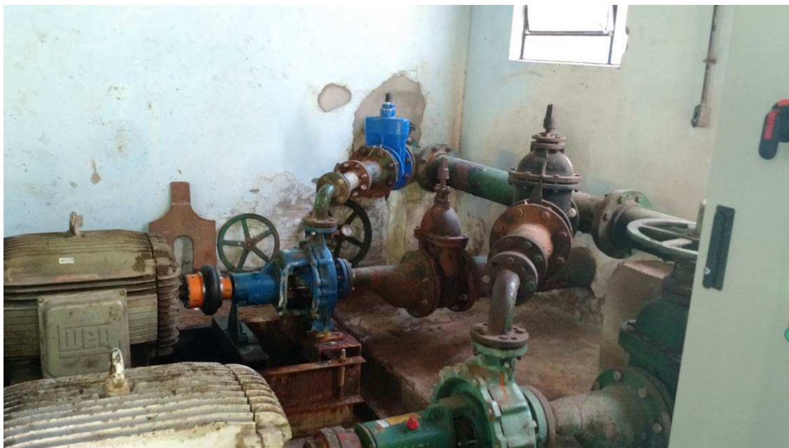
Foto 6 - Conjuntos motobomba da elevatória de água tratada junto à UTS
