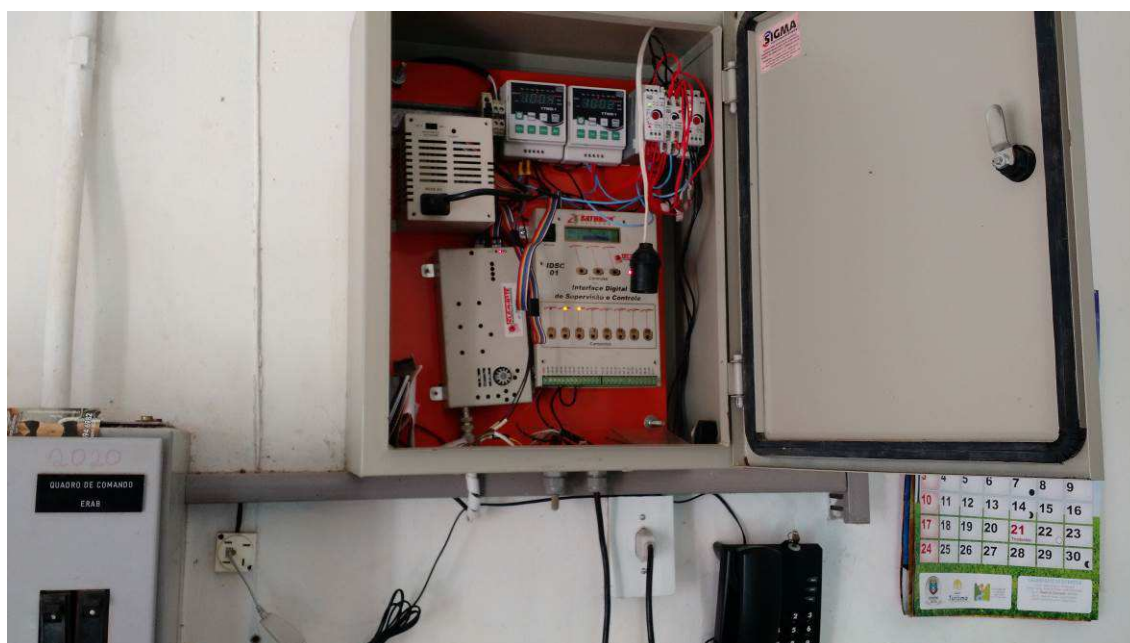
Foto 4 - Dispositivos de acionamento automático de elevatórias e discagem de alerta para desconformidades
