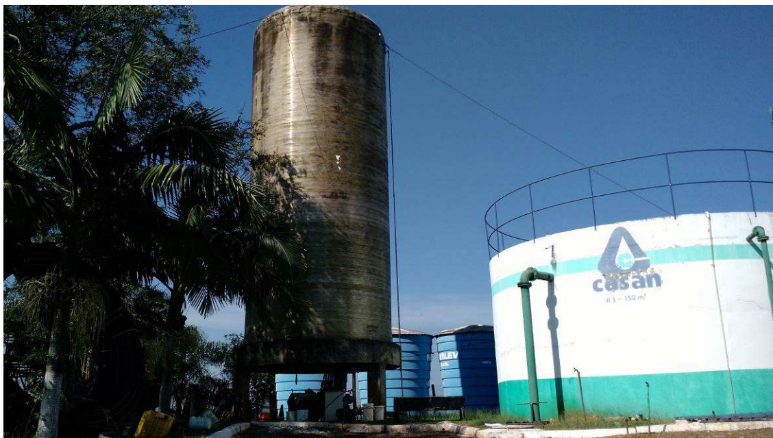
Foto 9 - Reservatórios: de 150 m 3 à direita; elevado de 115 m 3 à esquerda; 3 das 5 unidades de 20 m 3 ao fundo
