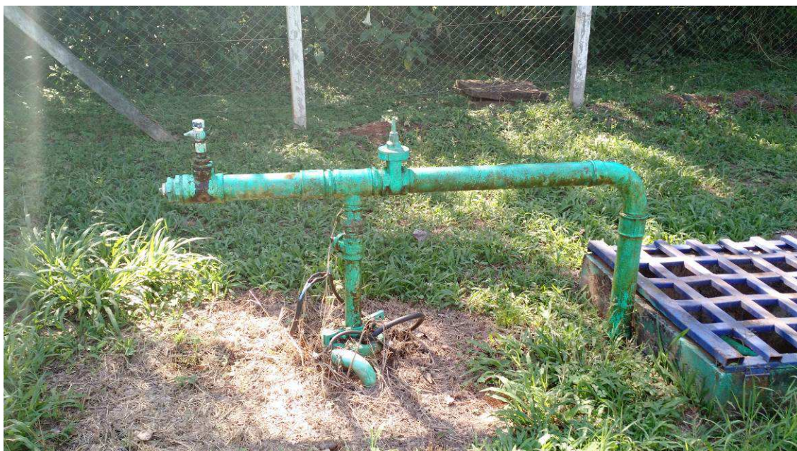
Foto 3 - Poço 2 com bomba submersa bombeando direto para o reservatório de contato junto ao Poço 1
