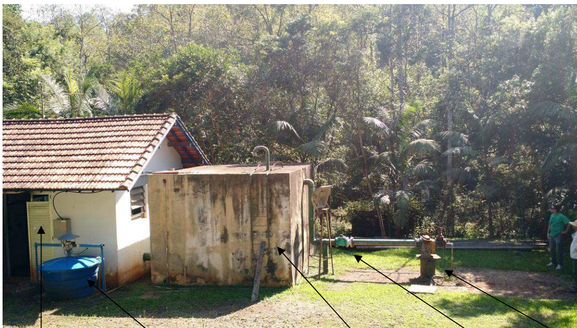
Foto 2 - Casa de bombas, tanque de dissolução do hipoclorito, reservatório de sucção/contacto, macromedidor e Poço 1.
